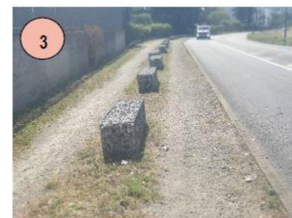
Déficit de revêtement qualitatif au droit de la station Total et parsemé d'obstacles
